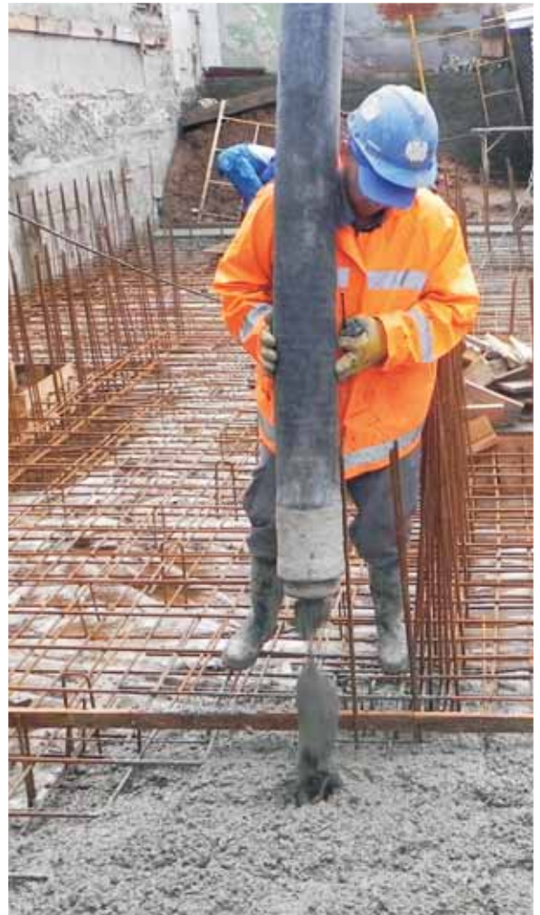
Llenado de losa de fundación de un edificio RBS con hormigón premezclado
